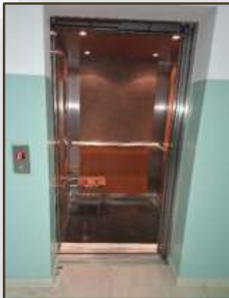
Εικόνα 87. Ανελκυστήρας (1 ο Δημοτικό σχολείο Αρχάνων Ηρακλείου Κρήτης)
