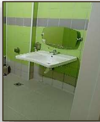
Εικόνα 179. Τουαλέτα (10° Δημοτικό σχολείο Κοζάνης)
