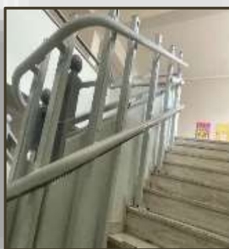
Εικόνα 92. Μηχανισμός για αναβατόριο κλίμακας (3ο Δημοτικό σχολείο Ηγουμενίτσας)
